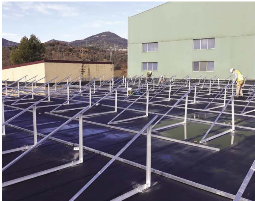
Instalación de placas solares en la ETAP de Graus
